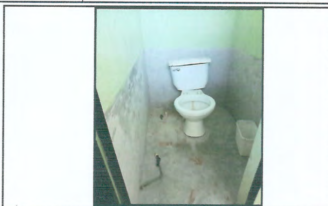
Foto 2: Baños en mal estado
