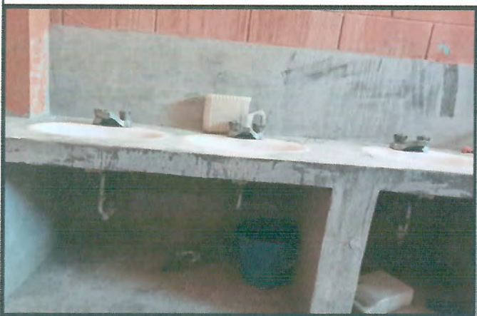
Foto 3: Estado de los lavamanos
